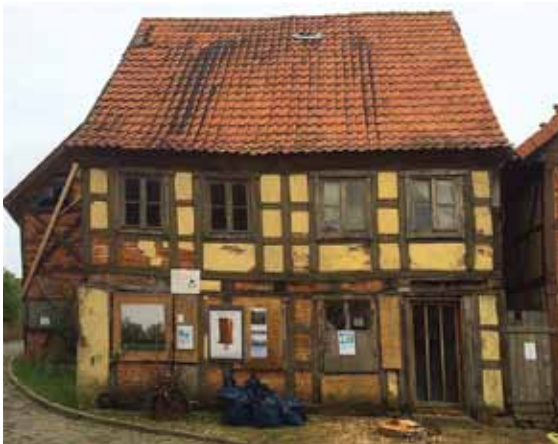
Aktueller Auftrag: die Sanierung eines Fachwerkhouses in der Hansestadt Werben im unmittelbaren Zentrum gegenüber der Salzkirche.
