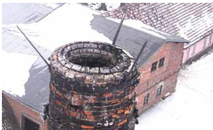
Schadenanalyse eines Schornsteinkopfes, Alte Ziegelei Westeregeln
